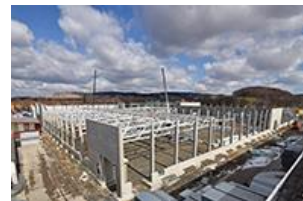
Die Baustelle für die neue Teilefertigungsstätte auf dem Gelände der Reisemobil-Fabrik Capron © Capron GmbH
